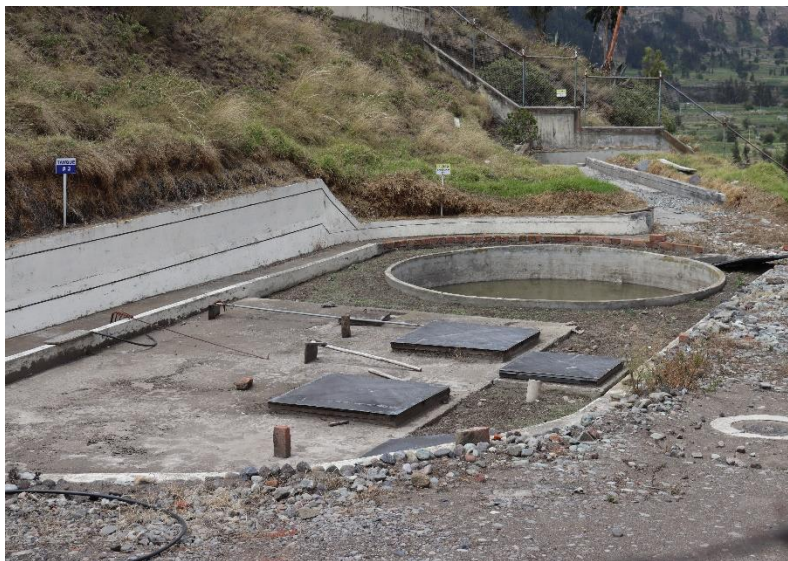
Fotografía 3: Planta de Tratamiento Jatun Salasaka Chilkapamba
